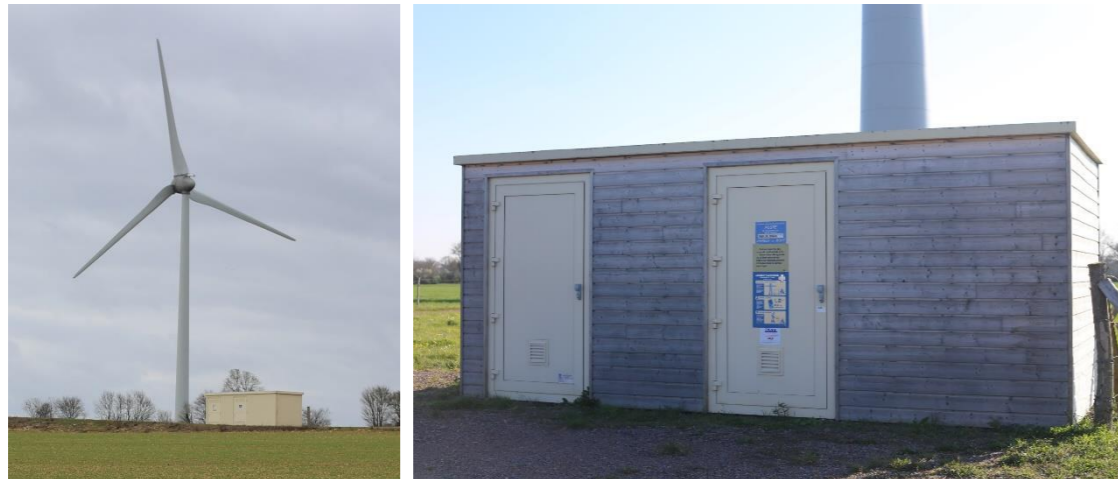
Photo 139 : exemples de poste de livraison électrique
