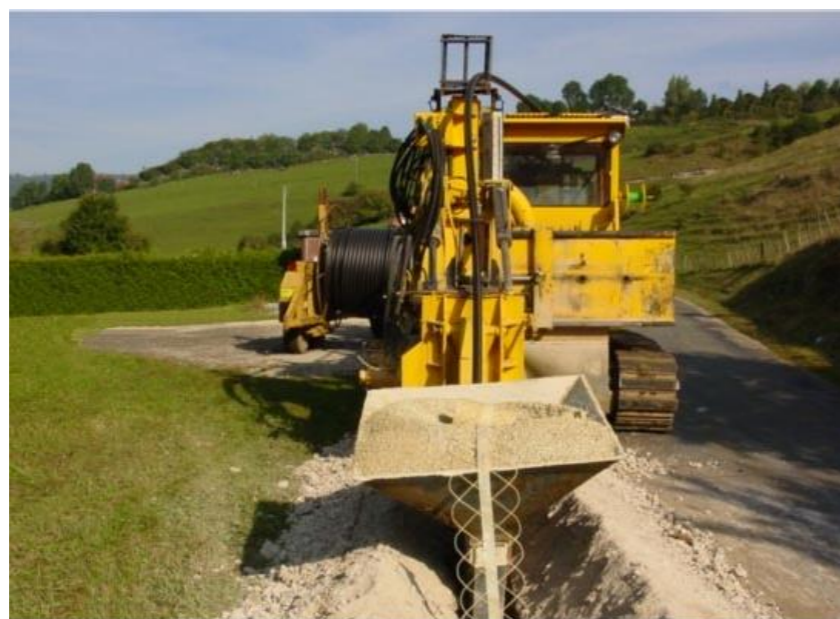
Photo 140 : la pose d'un câble souterrain depuis le poste de livraison jusqu'au réseau électrique public
